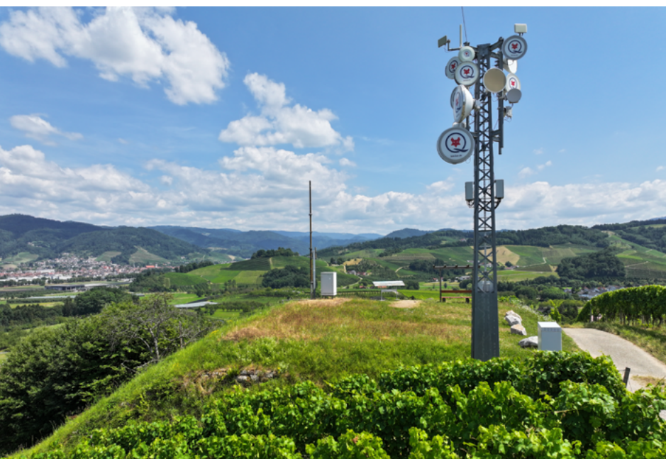
Richtfunkmast in Bottenau / Ortenaukreis
